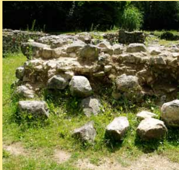
Schäden an der Ruine Burg Reitersdorf
